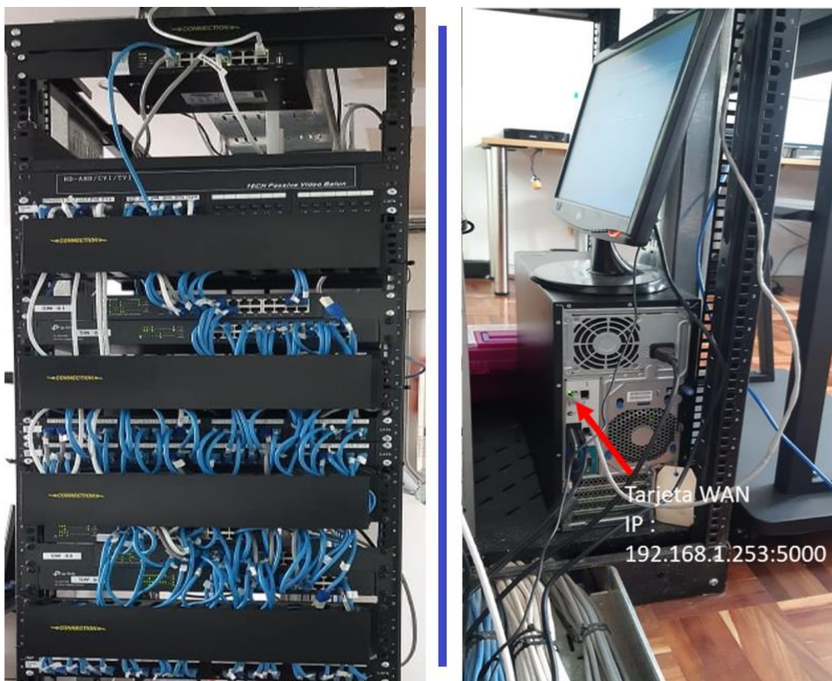
Figura 127. Ubicación del servidor NAS Synology DSM7.2 en el Rack de piso. Fuente: Las autoras.
